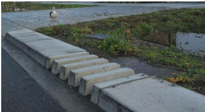
Figuur 23. Een voorbeeld van een boordsteen met splaten zoals toegepast in de Fortstraat in Mortsel (Bron: dbpubliekeruimte.info).
